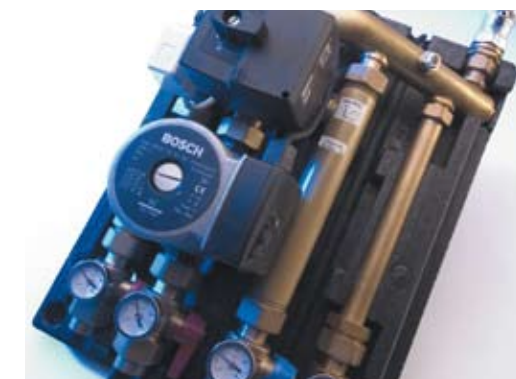
Aislamiento regulador de la calefacción
